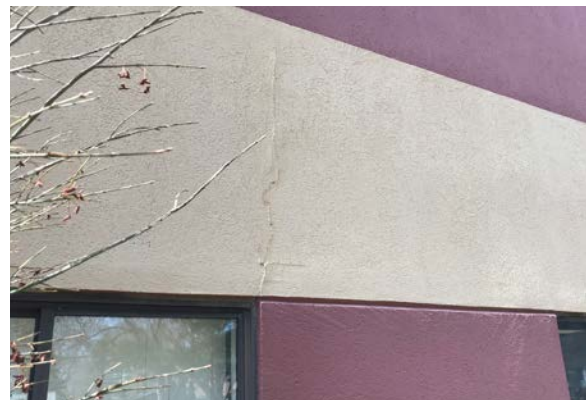
Exterior EIFS (peeling)
